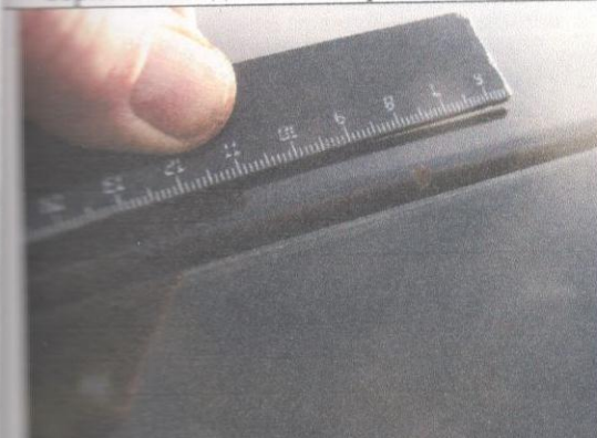
Крыло-НЛКП в виде сколов краски-окраска
